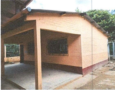
Foto1: Mejoramiento de paredes, el techo no tiene suficiente altura
